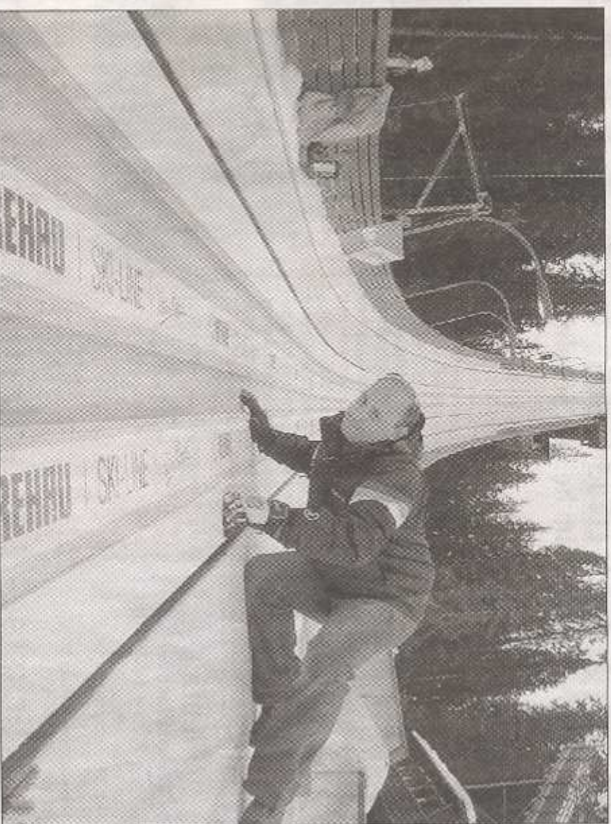
Peter Riedel aus Tellerhäuser prüft die Anlaufspur auf der Großschanze in Trondheim. Das von ihm erdachte System ermöglicht ganzjährig optimale, witterungsunabhängige Trainings- und Wettkampfbedingungen. – Foto: Frank
