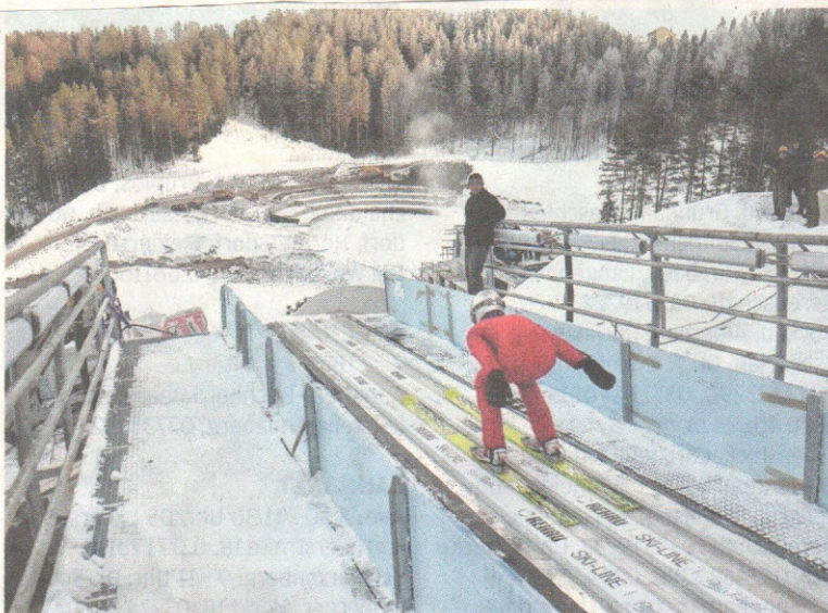
Blick vom Schanzentisch einer der neuen Anlagen in Tschaikowski (Russland) auf das Areal mit den Zuschauertribünen. Vieles ist noch im Bau, aber die ersten zwei von fünf Schanzen werden nächste Woche eingeweiht. FOTO: PRIVAT
